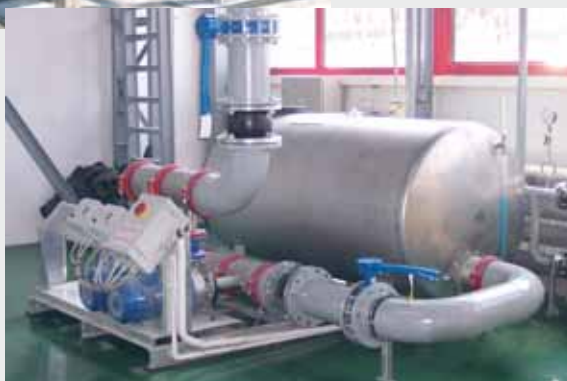
Stacja pomp ze zbiornikiem
